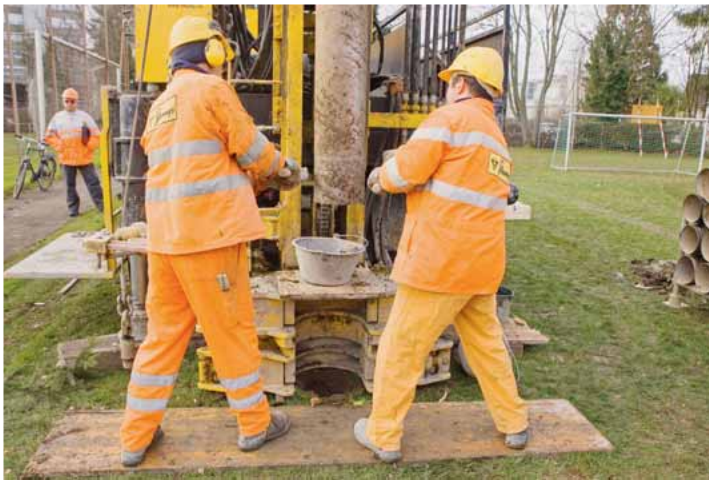
Nach den Probebohrungen , die diese Woche gestartet sind, wird im nächsten Frühling die Versuchsgrube ausgehoben. Bild: Olivier Sauter
